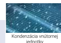
Kondenzácia vnútornej jednotky
